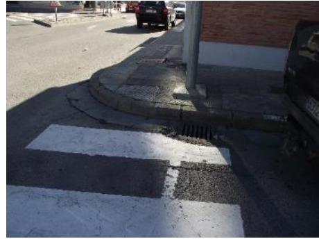
Imagen 54. Vista de un paso de peatones sin rebaje de bordillos
